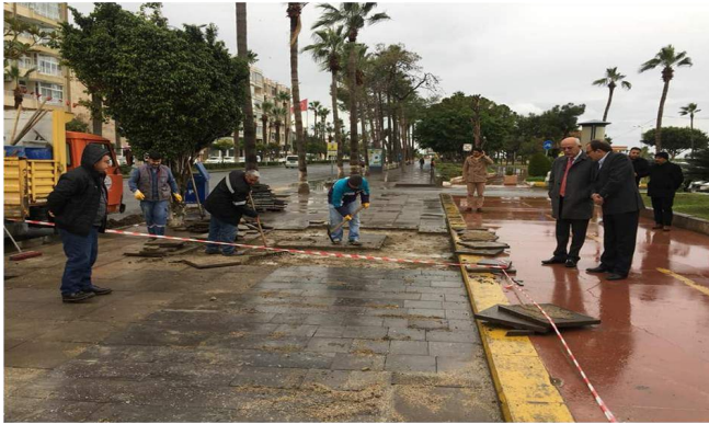
51-Fen İşlerine bağlı ekiplerimiz şiddetli fırtına lodos ve fırtınadan dolayı sahil bandımızda oluşan tahribat ve çeşitli nedenlerle bozulan kırılan andezit taşlarının gerekli tamirat ve bakımları yapılmıştır.
