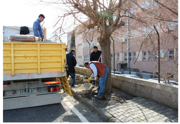
50-Fen İşleri Müdürlüğüne bağlı ekipler tarafından İlçemiz Fatih Sultan Mehmet mahallesinde muhtelif cadde ve sokaklarında bozulmuş tahrip olmuş kaldırımların bakım onarımı yapılmıştır.
