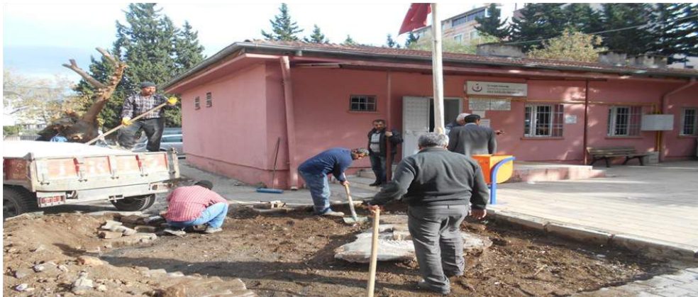
16- Denizciler mahallesinde Aile Sağlık merkezi önünde vatandaşlarımıza daha iyi hizmet verebilmek için Fen İşleri Müdürlüğü'ne bağlı ekipler tarafından bozulan, deforme olan parke tamirata yapılmıştır.
